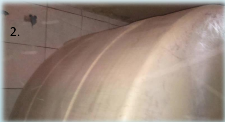
2. Caixa de água (antiga caixa de gordura)
